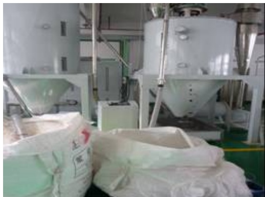
同加工基地①廃 PET 再生処理工場（洗浄工程の後の乾燥工程）PET 以外でも使用。
