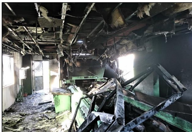
火災事故現場の様子
