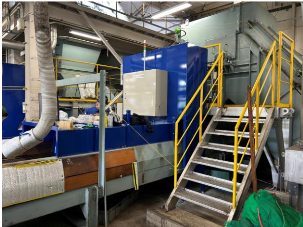
既設コンベヤ上に 省スペース設置
